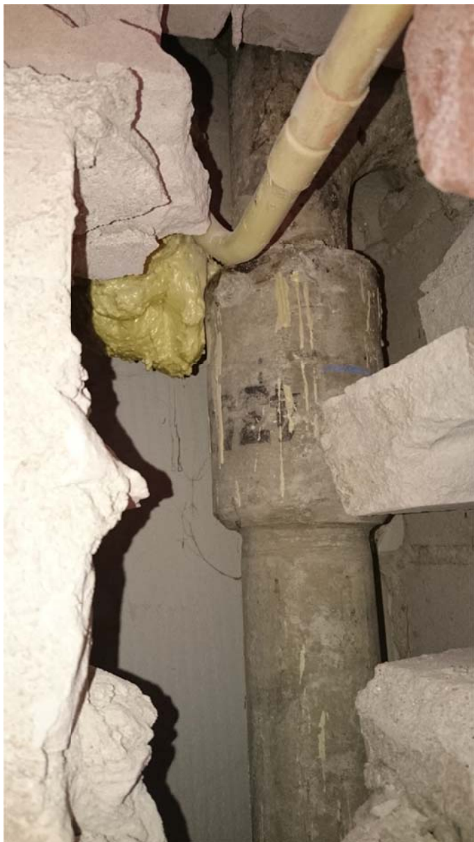
Foto 7: Asbesthoudend cement (lood niet zichtbaar)
