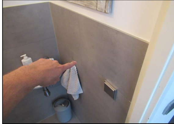
2. Holklinkende afwerkingen tpv toilet.
