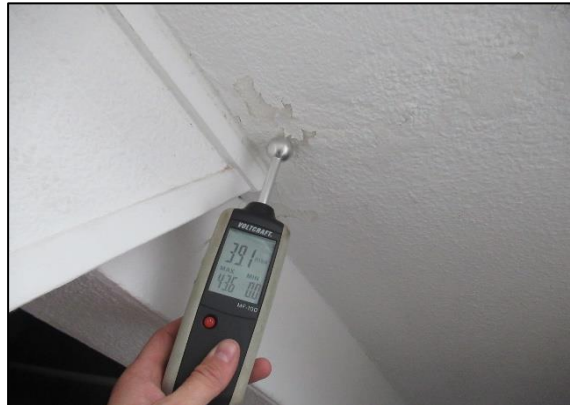
16. Vochtinwerking geconstateerd tpv dakkapel achterzijde woning.
