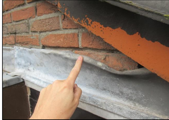
8. Onthecht loodwerk tpv gevel aansluiting zichtbaar.
