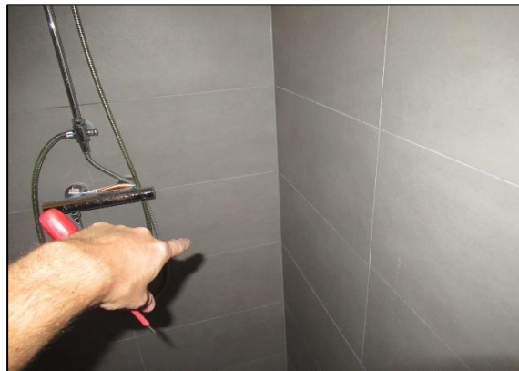
10. Holklinkende afwerkingen tpv badkamer.
