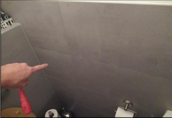
13. Holklinkende afwerkingen tpv toilet eerste verdieping.
