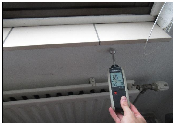
18. Vochtinwerking geconstateerd tpv dakkapel achterzijde woning.
