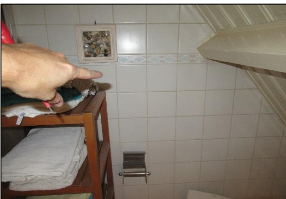
11. Holklinkende afwerkingen tpv badkamer.
