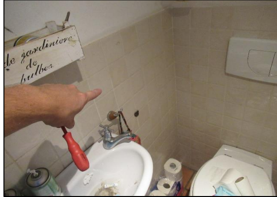
2. Holklinkende afwerkingen tpv toilet.
