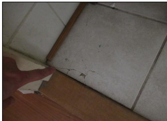
8. Beschadigde afwerkingen tpv badkamer.
