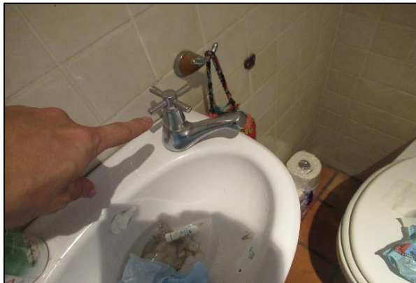
7. Speling op kraan tpv toilet.
