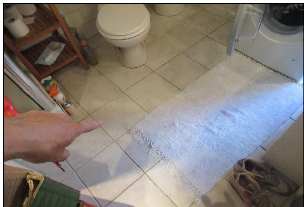
7. Holklinkende afwerkingen tpv badkamer.
