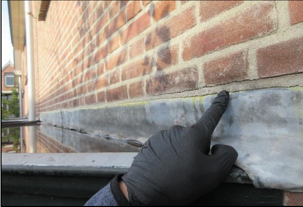
1. Poreus/loszittend voegwerk tpv loodslab.
