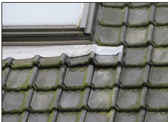
6. Dakpannen liggen onregelmatig.
