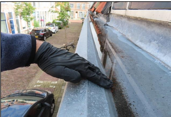
3. Gootinlage hangt scheef. Hierdoor is het mogelijk dat het water over de rand heen stroomt. Situatie oogt functioneel (geen lekkagesporen zichtbaar), eventuele verbeteringen, PM.
