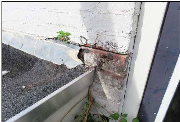
13. Ontbrekende waterkering (loodwerk).
