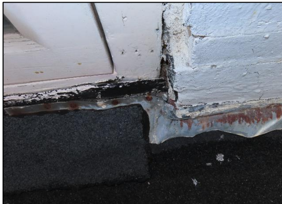
8. Loodwerk sluit niet goed aan.
