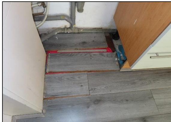
4. Vloerafwerking van afgeschreven kwaliteit: vervangen, nader te bepalen in verbouwplan, PM.
