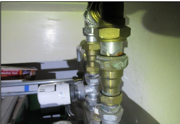
3. (Oude) lekkage sporen zichtbaar.
